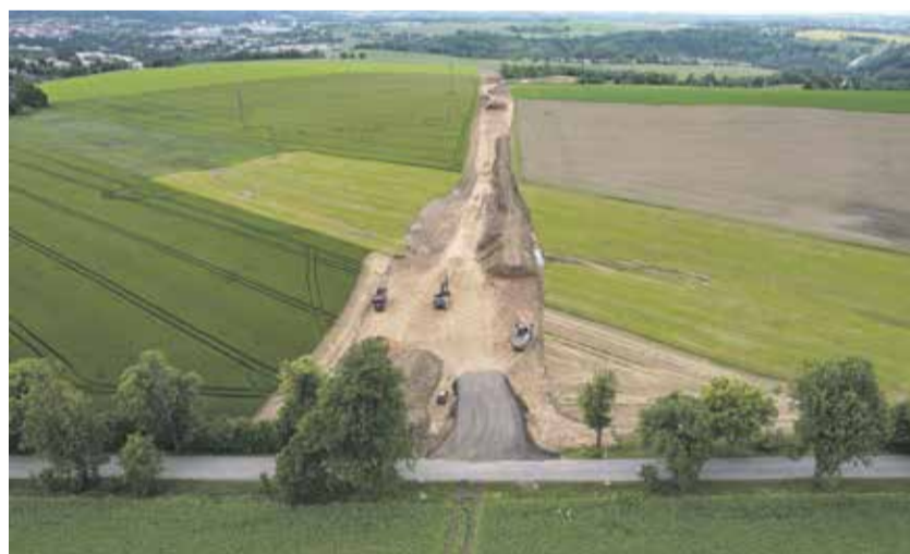
V plném proudu je stavba východní části jihovýchodního obchvatu krajského města. FOTO: KRAJ VYSOČINA
